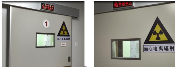
图 3-3 本项目手术室当心电离辐射警示标志、工作状态指示灯
