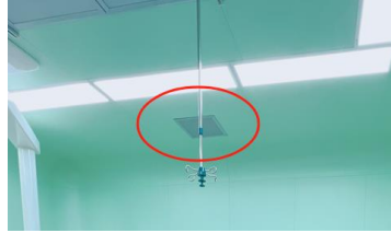
图 3-7 本项目手术室顶部排风口
